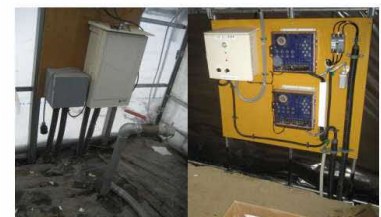
写真1 かん水・給液タイマー機器
