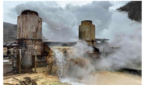
地熱バイナリー発電所（奥尻町）
