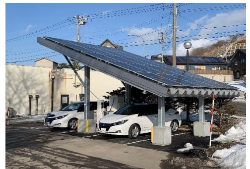
電気自動車とソーラーカーポート
